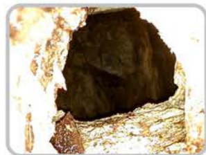
覆工背面空洞画像
